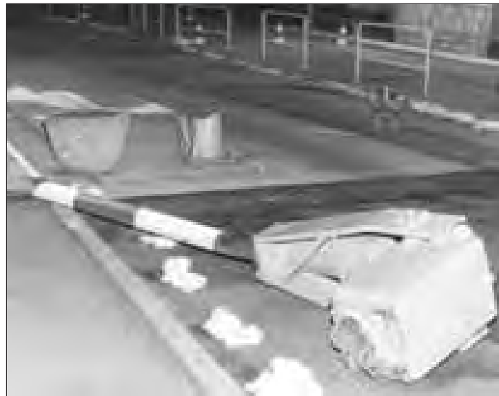
Die beschädigte Grenzanlage der Glienicker Brücke.
